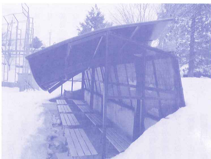
雪の重さで壊れたベンチの屋根 (運動公園わいWai)
