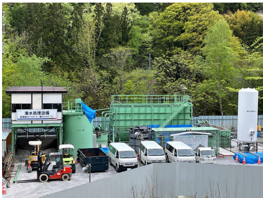
濁水プラント
