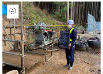
④ 【削孔長確認】 孔の長さ（削孔長）を確認します。外のケーシングの長さ（残尺）を計ります。
