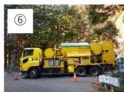
⑥ ジェットモービル車で特殊コンクリートを練ります。
