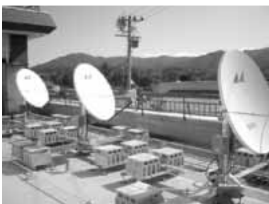
役場に設置されたBS・CSアンテナ
